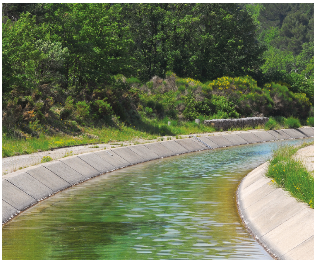
Canal de Provence A. Van der Stegen
