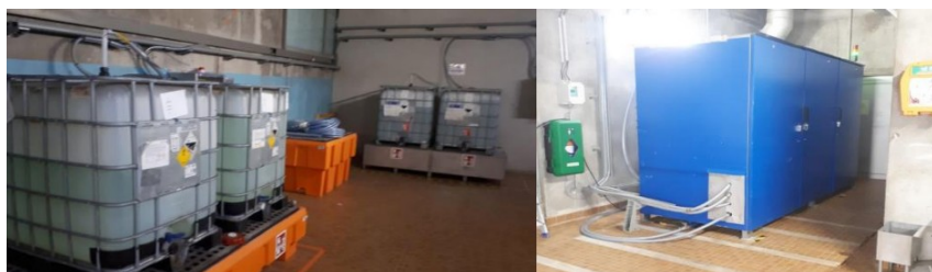
Traitement de désinfection des eaux traitées pour la 2 ème année
