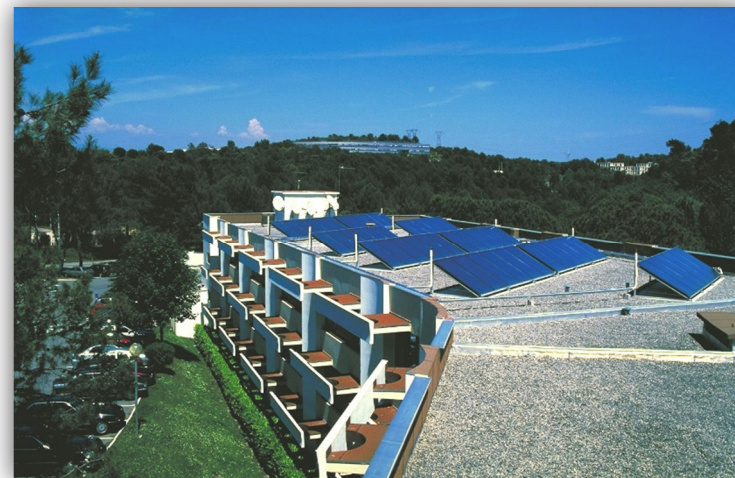
Image 5 - Installation solaire collective - Sophia Antipolis (06) - Crédit : Région PACA - DATTE - STE
